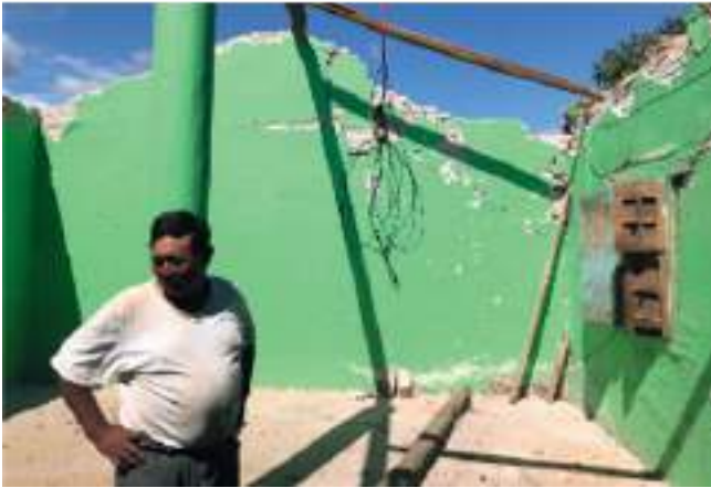
Figura 3. Vivienda dañada en la comunidad de Ixtepec, Oaxaca
