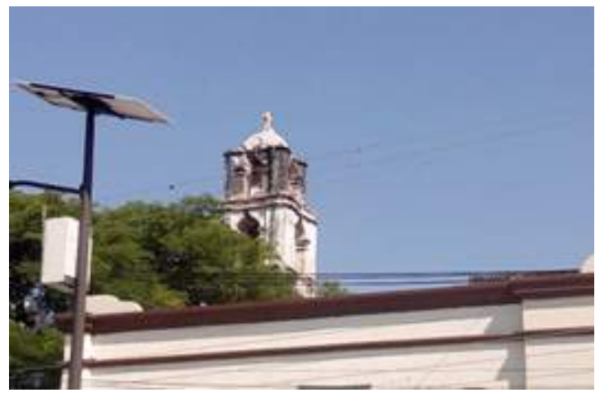
Figura 10. Campanario del templo de San Marcos con afectaciones estructurales y colapsos. Fuente: Elaboración propia.
