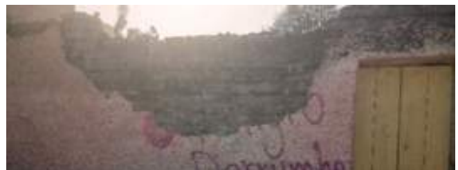
Figura 7. Vivienda de adobe en la periferia de Tlayecac, con afectaciones considerables
