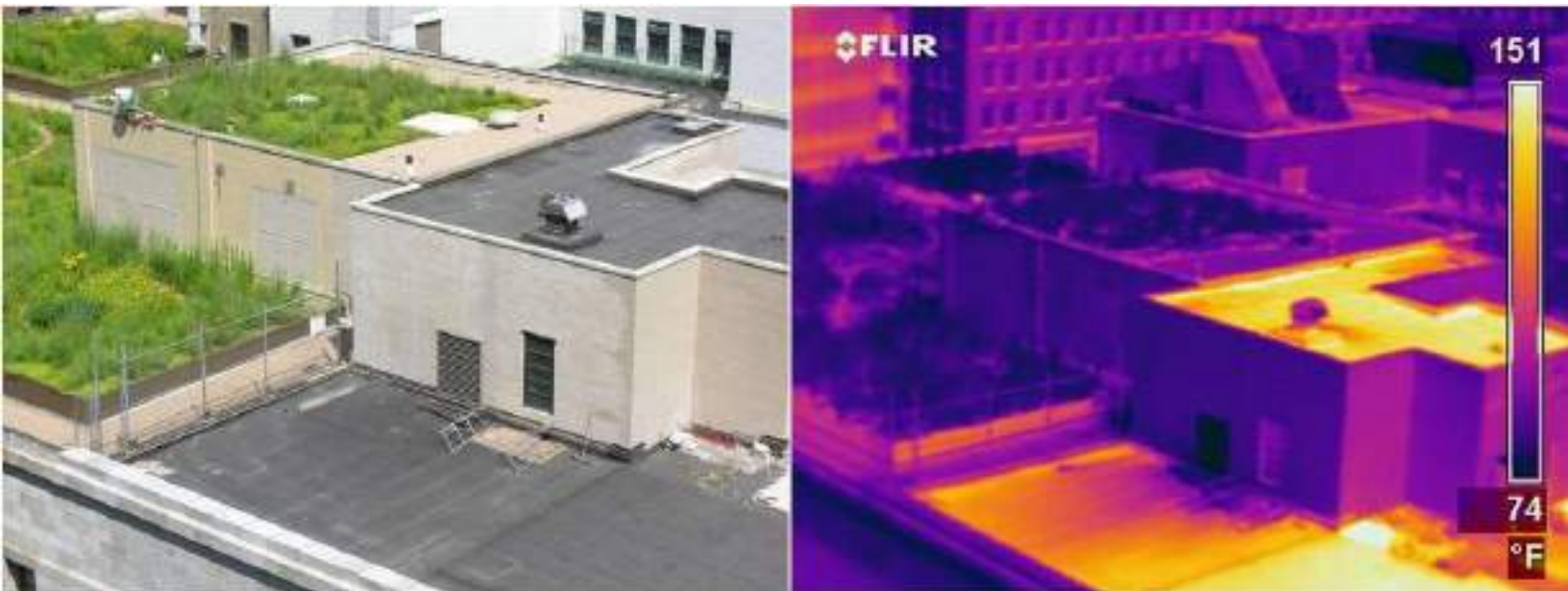
Figura 7. Comparativa del Ayuntamiento de Chicago con una imagen normal y otra con cámara infrarroja donde se muestra la diferencia de temperatura entre una losa de azotea normal y otra con naturación. Fuente: (Science Connected, 2016)
