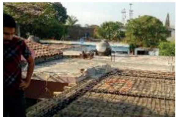
Figura 7. Supervisión de obra por parte de los arquitectos del nodo Oaxaca. Fuente: Acervo propio, por Arq. Erick David Ramírez, 2017.
