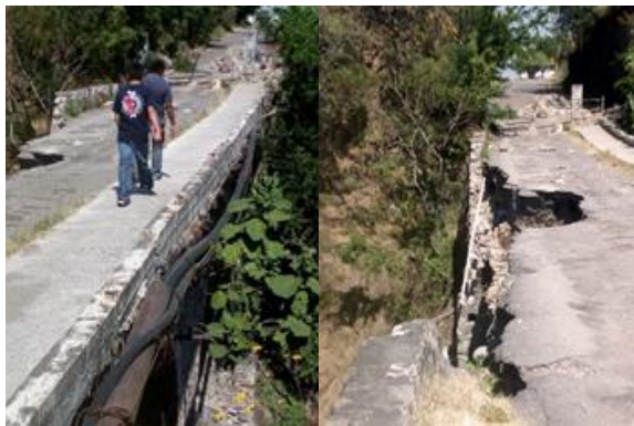
Figura 11 y 12. De izquierda a derecha: Puente Viejo de acceso a Tlayecac, donde pese al riesgo de no tener barandal y un daño estructural, la gente lo sigue utilizando, y zona inhabilitada para uso vehicular Fuente: elaboración propia
