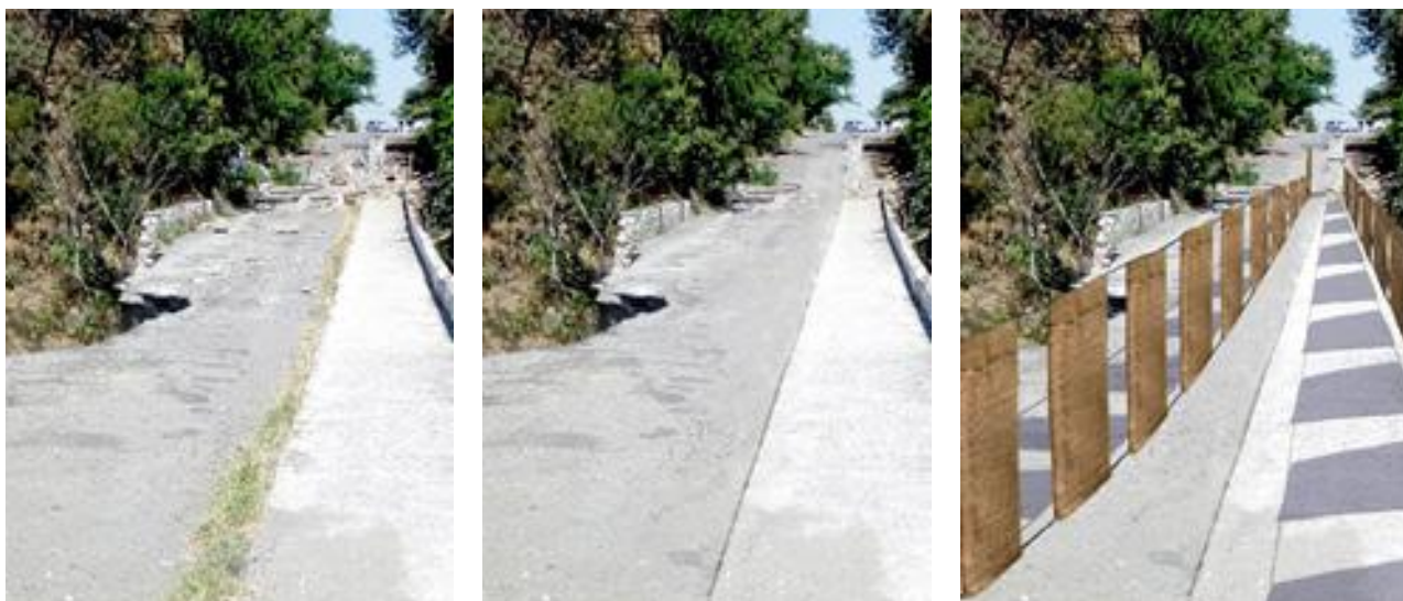
Figura 14, 15 y 16. De izquierda a derecha: estado actual, limpieza del puente y colocación de barrera física a través de costales de yute
