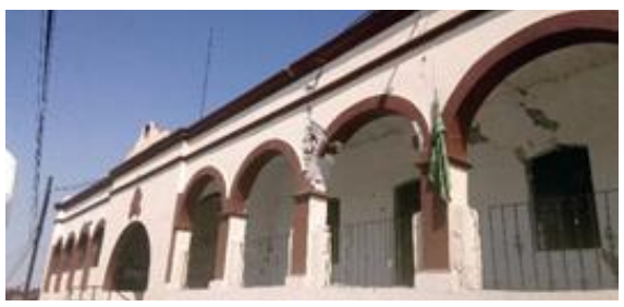
Figura 9. Ayudantía con severas afectaciones estructurales, inmueble a demolerse. Fuente: elaboración propia
