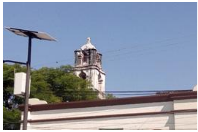
Figura 10. Campanario del templo de San Marcos con afectaciones estructurales y colapsos. Fuente: Elaboración propia.
