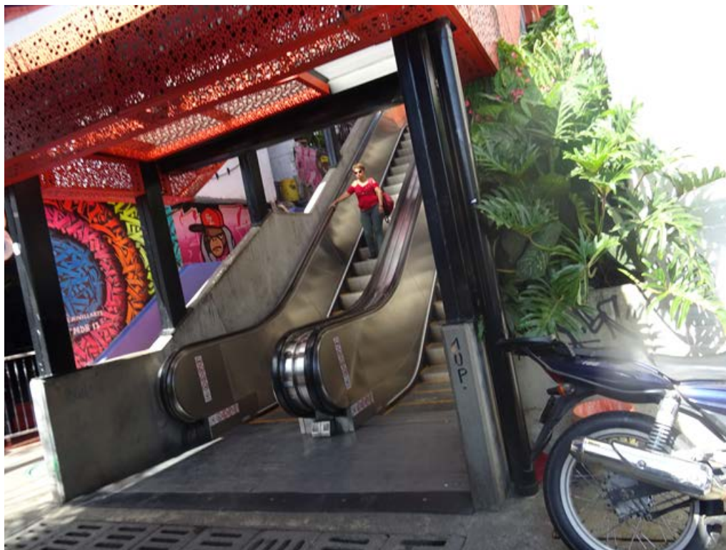
Figura 1. Escaleras eléctricas de Las Independencias I en Medellín (2022).
